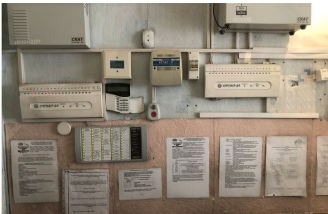
Рисунок 1 – Автоматическая пожарная сигнализация «Юнитроник-496»
