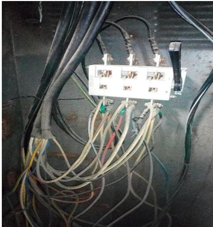
Рисунок 2 – Первый основной распределительный щит
