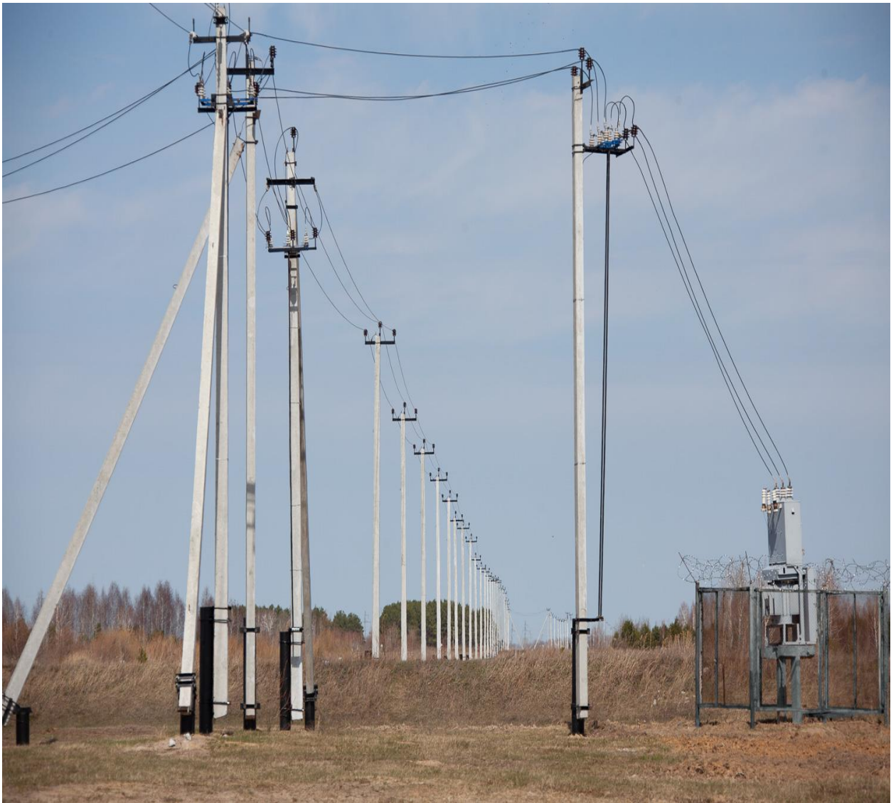
Рисунок 6 – Воздушные линии 10 кВ
