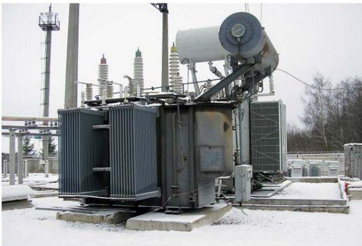
Рисунок 5 – Трансформатор ТМН 110/10 кВ мощностью 6,3 МВА
