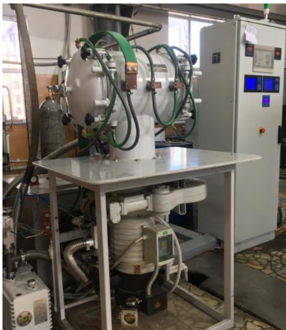
Рисунок 25 – Внешний электропечи вакуумной СНВЭ-1.3.1/20 И5
