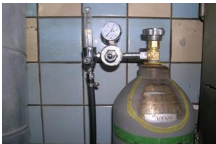
Рисунок 8 – Баллон с аргоном и блок подготовки газа
