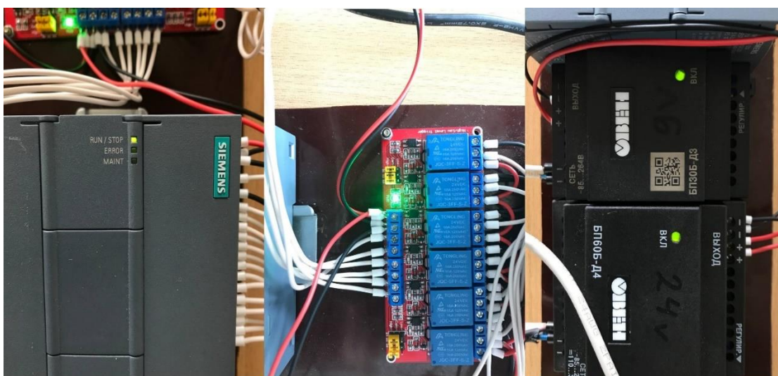
Рисунок 21 – Проверка индикаторов питания на блоках управления и силовой части
