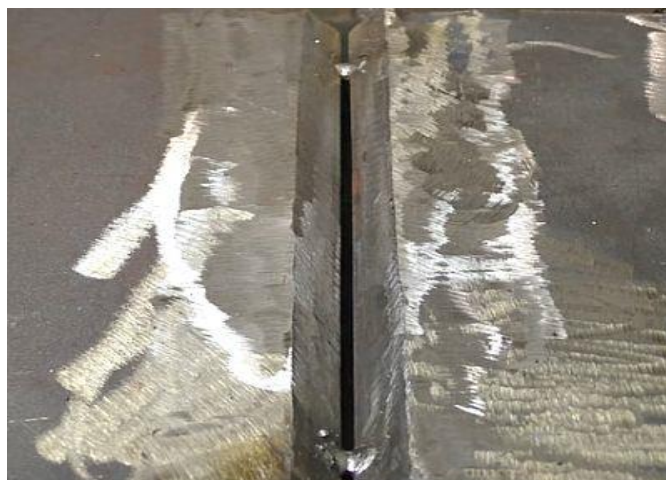
Рисунок 11 - Выборка трещин на участке ковша экскаватора
