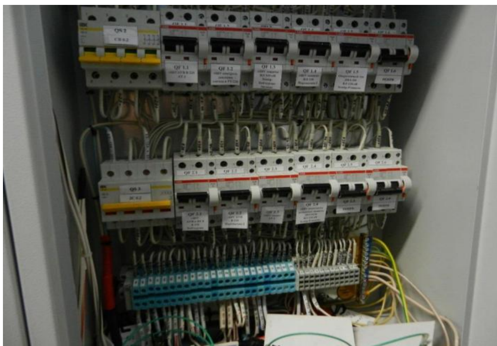
Рисунок 6 – Существующий шкаф ШРОТ-2
