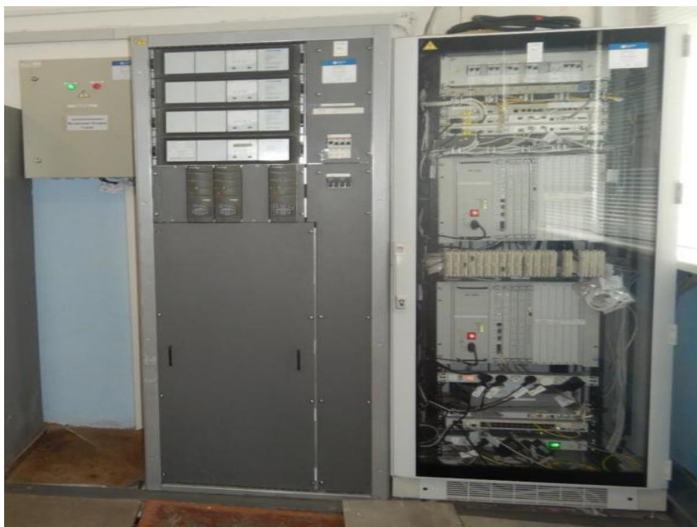
Рисунок 20 – Оборудование связи в ГЩУ
