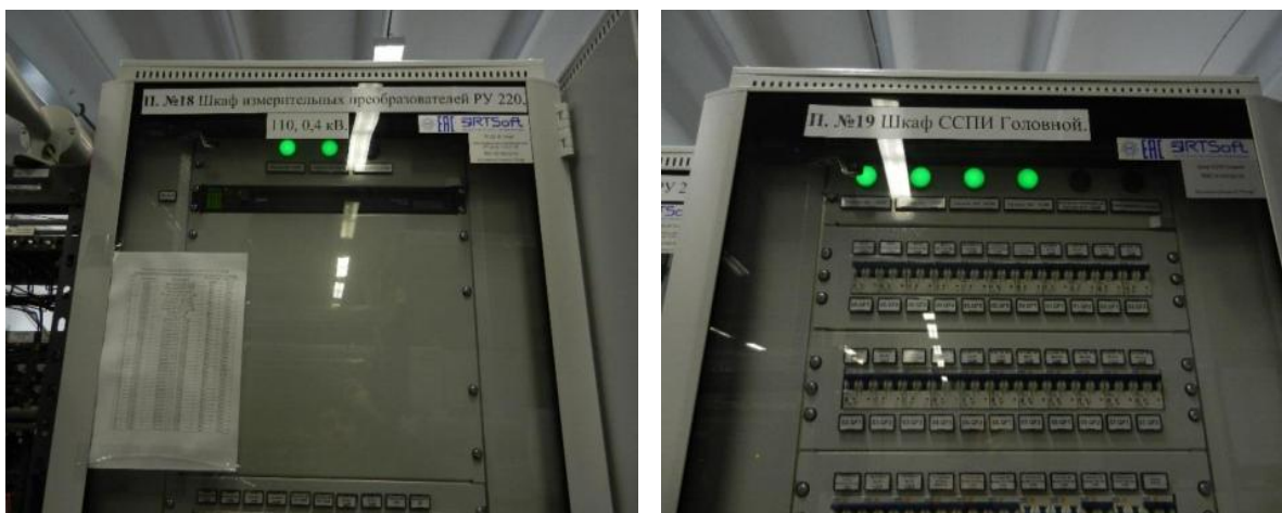
Рисунки 13 – Существующее оборудование ССПИ на ПС 220 кВ
