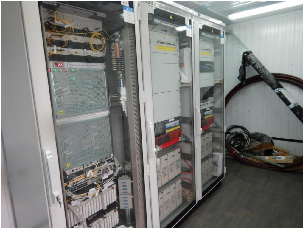
Рисунок 21 – Оборудование связи в контейнере связи
