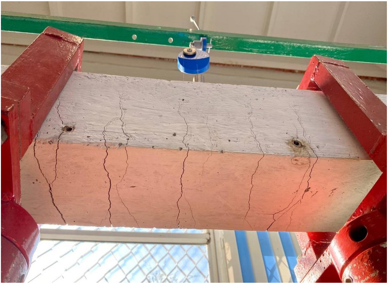
Рисунок 25 – Трещины в зоне растяжения арматуры балки сплошного сечения
