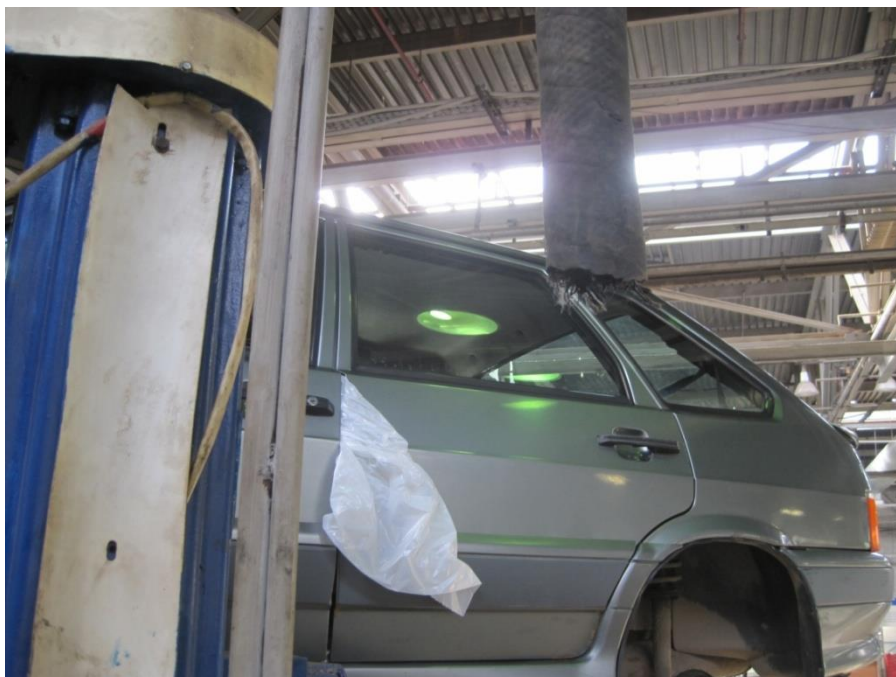
Рисунок 4.1 – отвод трубы вентиляции к рабочему посту в ОАО «Самара-Лада»
