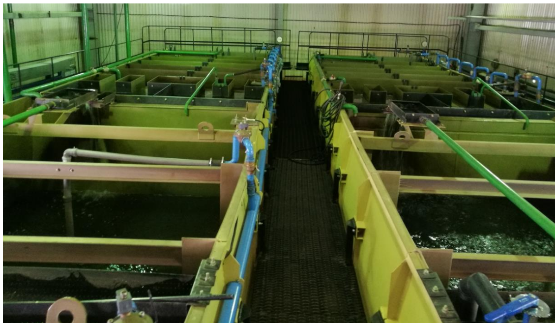
Рисунок 1 – Станция биологической очистки СБОСВ-200
