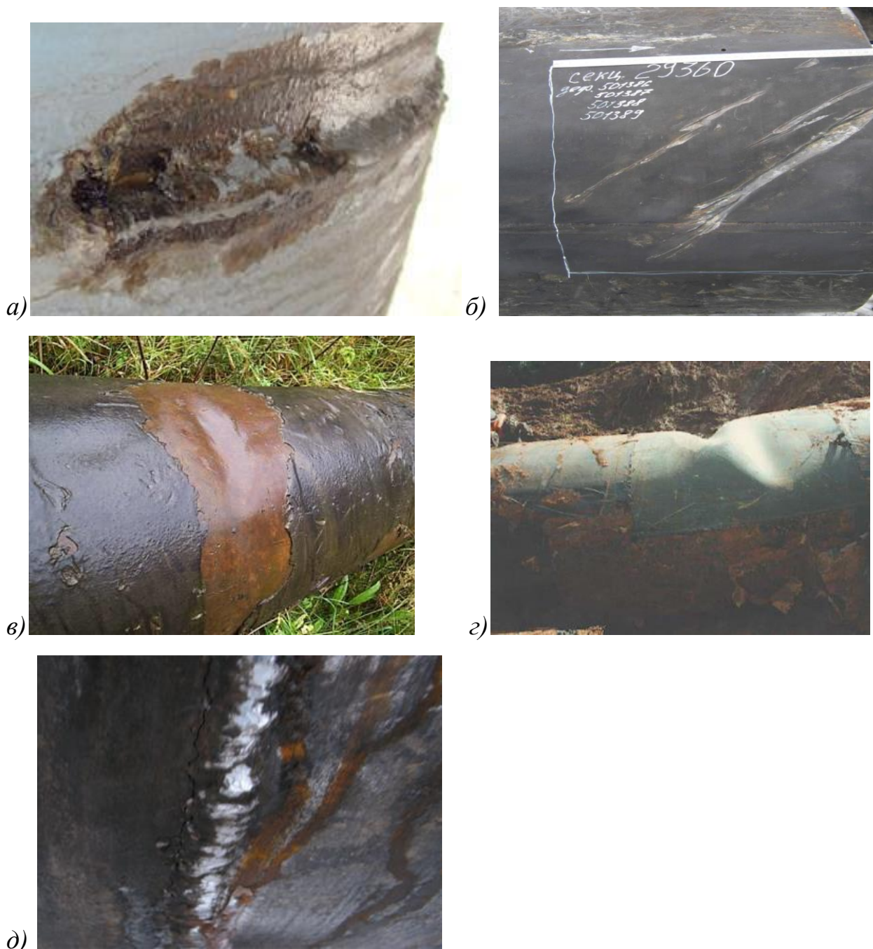
а) потери металла; б) риски; в) вмятины; г) гофры; д) изъяны сварных швов
