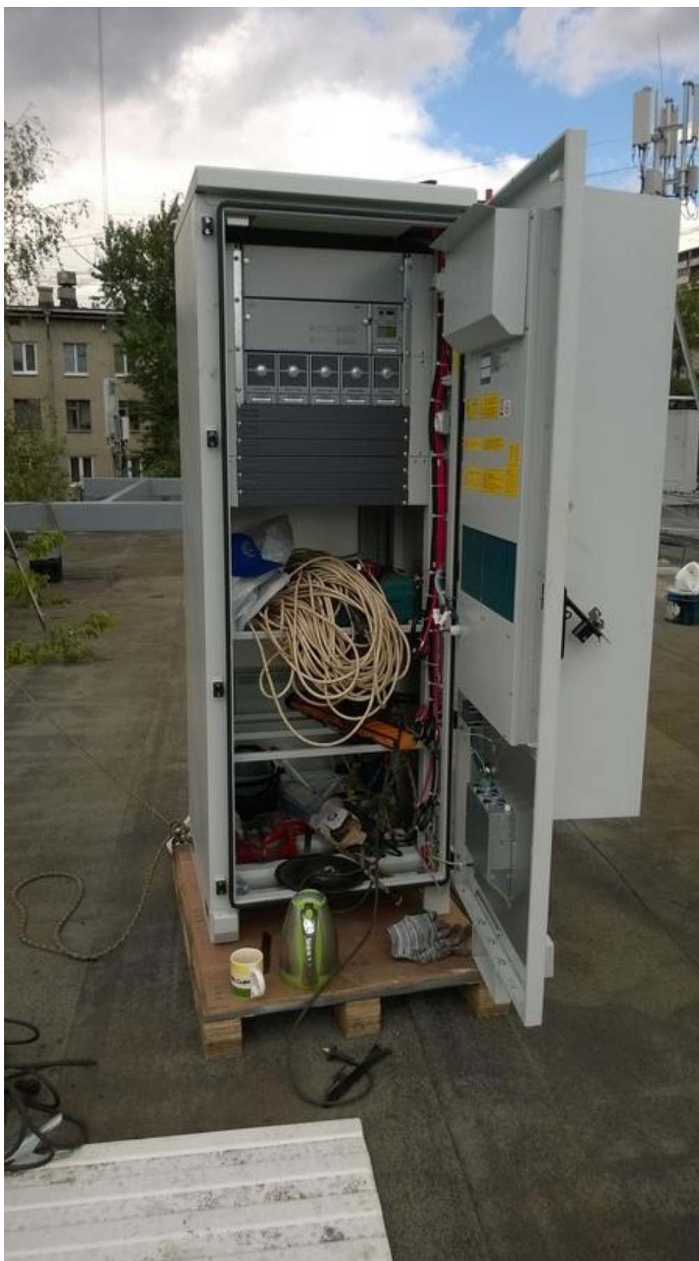
Рисунок 2 – Шкаф с оборудованием
