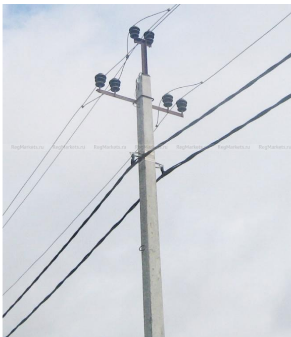
Рисунок 11 – Железобетонная опора на базе стоек СВ-105
