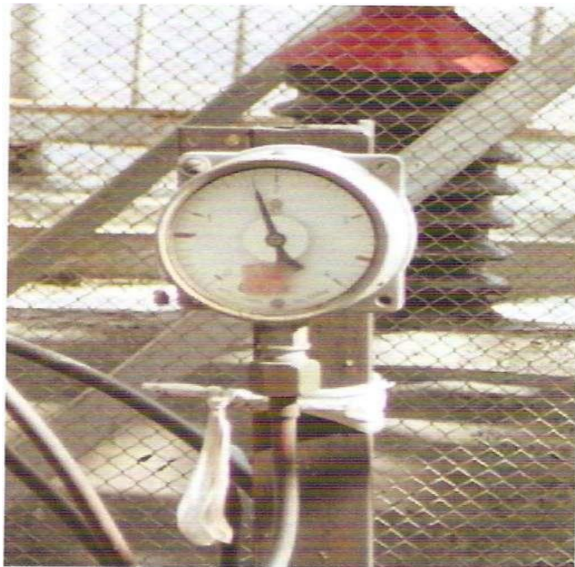
Рисунок А.3- Манометр давления масла на вводе трансформатора
