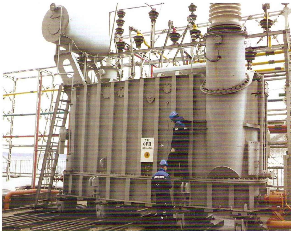
Рисунок А.1 - Общий вид трансформатора, установленного на Жигулевской ГЭС
