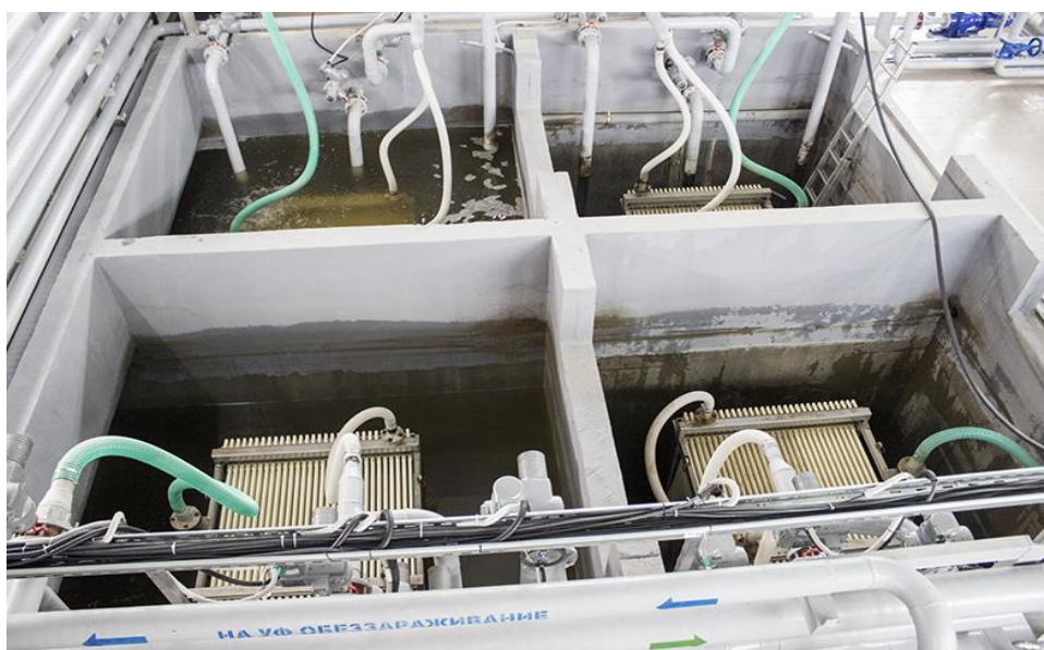
Рисунок 3 – Биореактор со смонтированными кассетами
