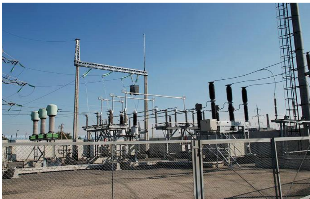
Рисунок 1 - Трансформаторная подстанция 110/10 кВ «Юрино» Технологическое оборудование подстанции
