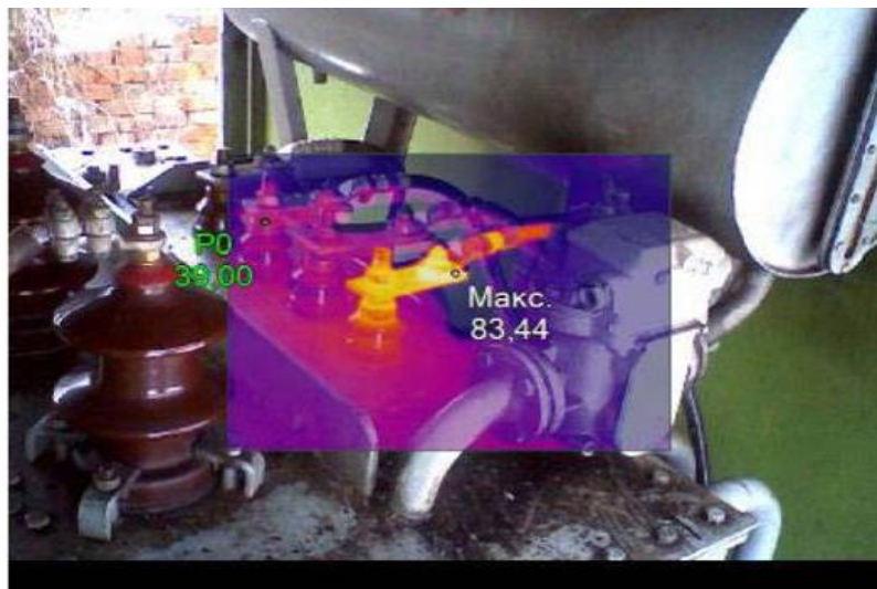
Рисунок 15 - Дефектное соединение на одной из фаз имеет перегрев 44,4 °С
