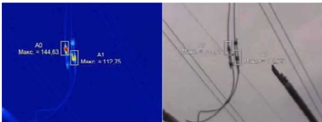
Рисунок 13– Тепловизионное исследование высоковольтных линий
