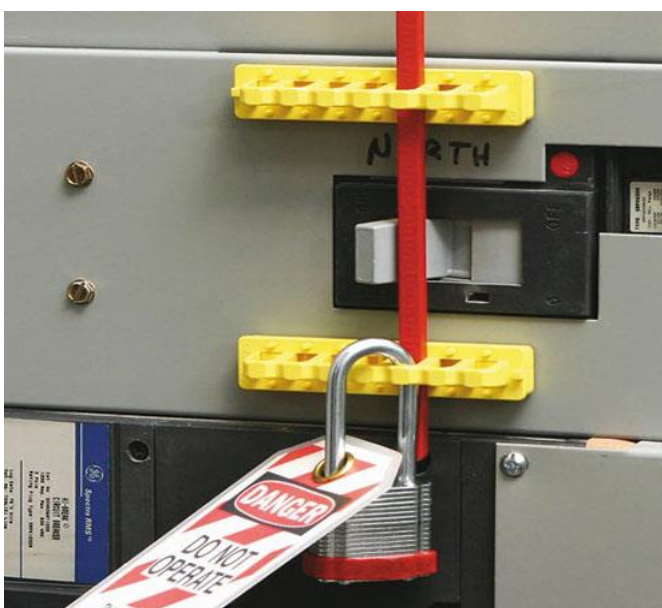
Рисунок 6 - Электрическая блокировка с навесным замком
