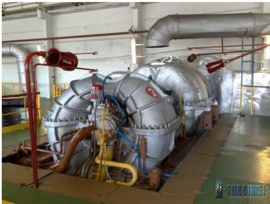
Рисунок 3 – Газоперекачивающая установка ГТК-10-4
