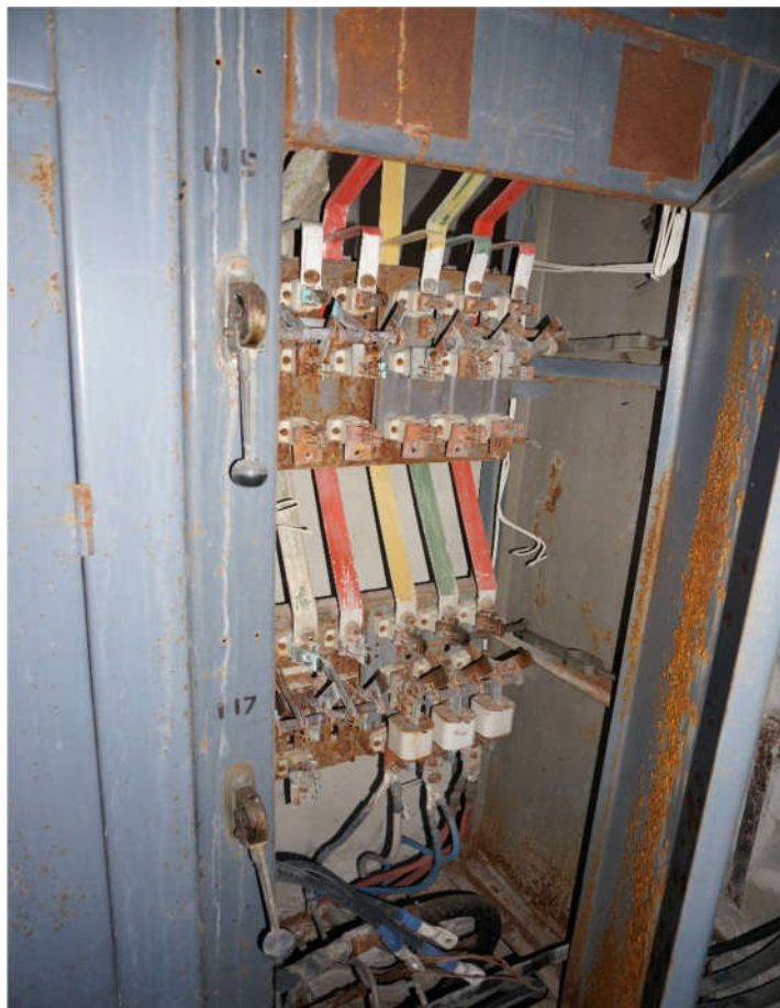
Рисунок 5 – Состояние шкафа РУ ТП-11
