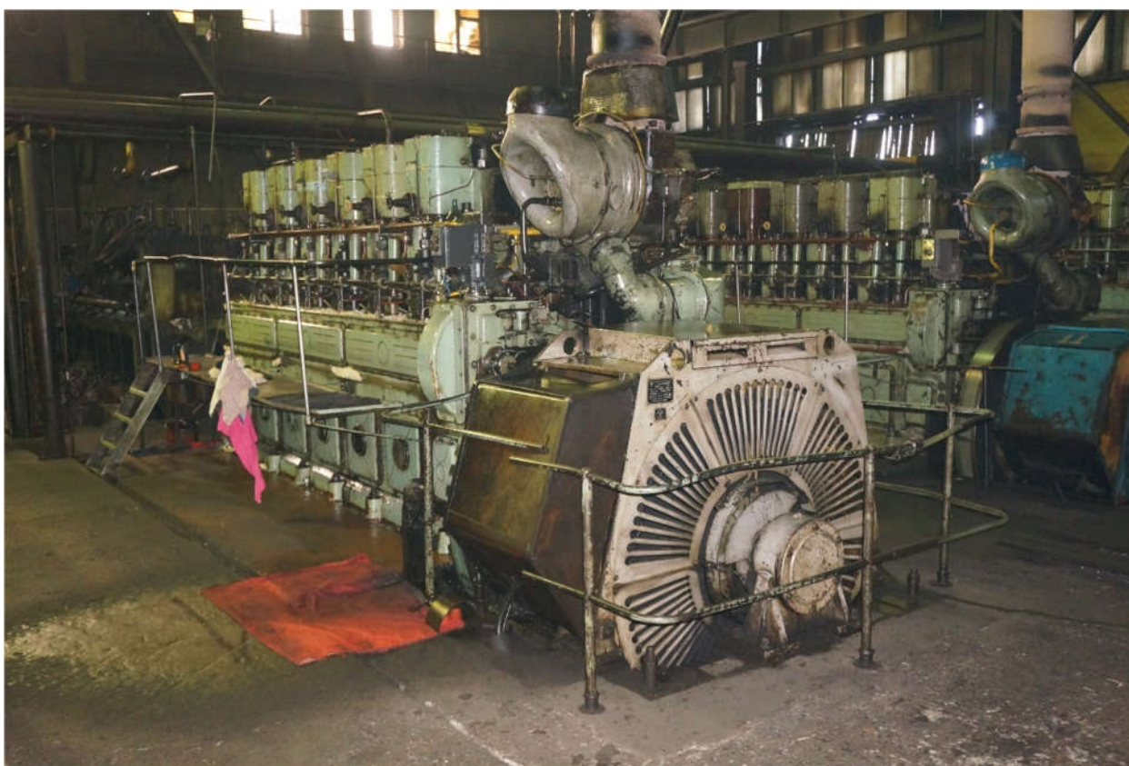
Рисунок 2 – Дизель-генераторная установка мощностью 1000 кВА
