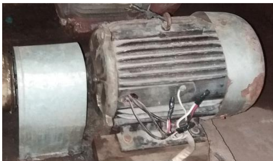
Рисунок 4 – Состояние электродвигателя вибропитателя А-706/3
