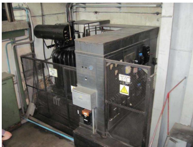
Рисунок 3 – Существующее РУ-0,4кВ 15ТС и щит 0,4кВ 15ТС
