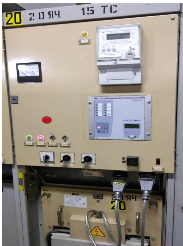
Рисунок 4 – Вводная ячейка 10кВ трансформатора 15ТС
