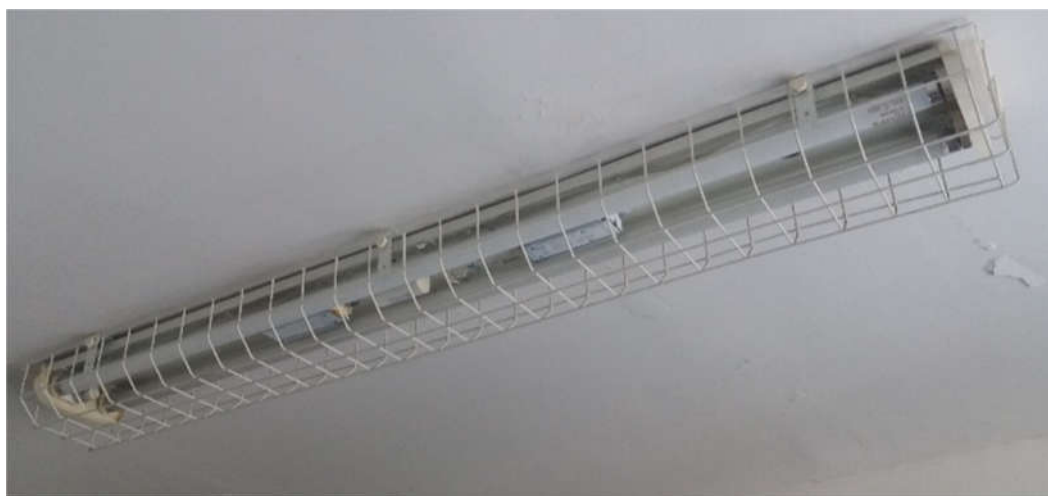
Рисунок 2 – Отсутствие рассеивателя на светильнике
