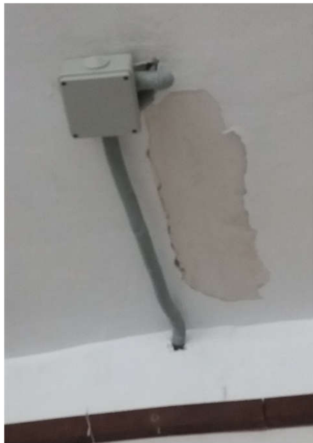
Рисунок 6 – Недопустимая прокладка кабеля
