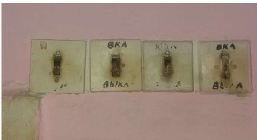
Рисунок 3 – Удручающее состояние выключателей
