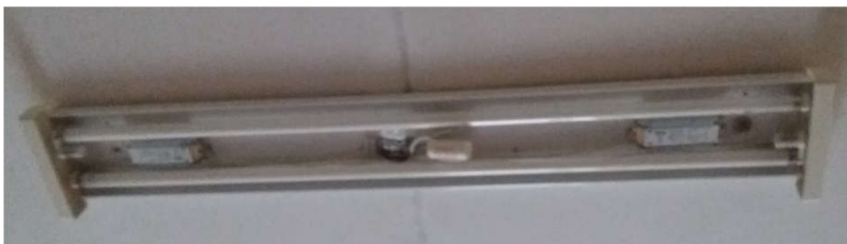
Рисунок 4 – Отсутствие рассеивателя или защитного плафона на светильнике
