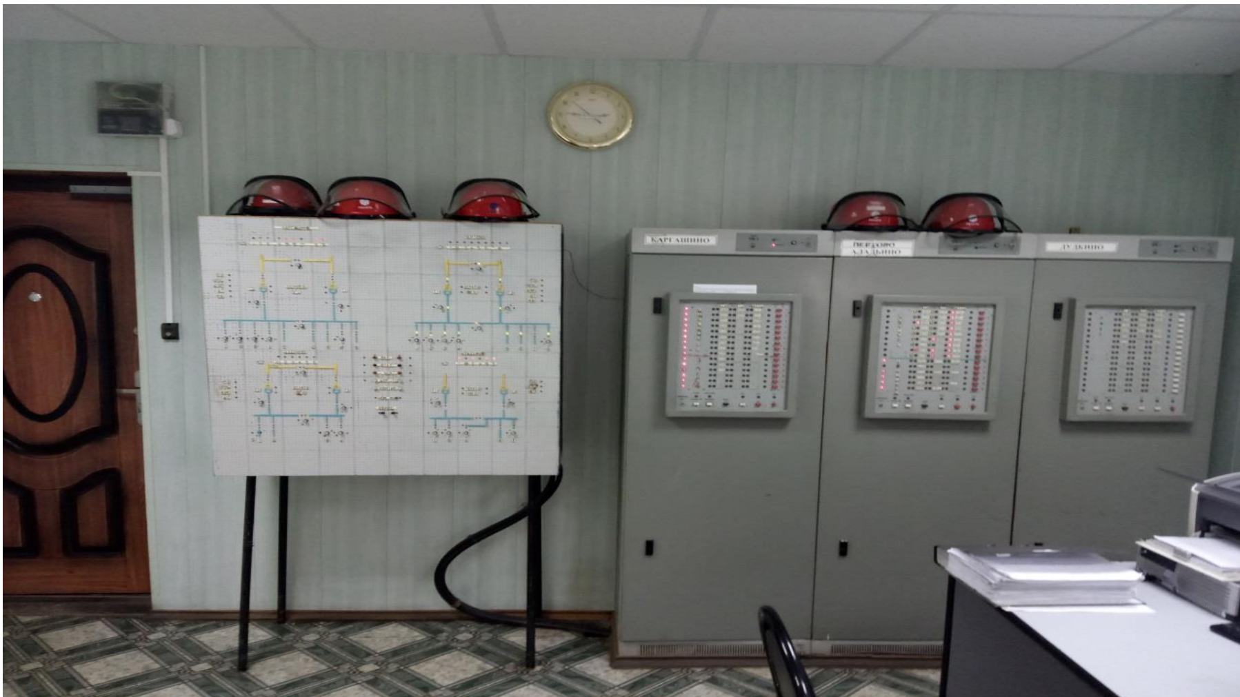
Рисунок 1 - Устройства телесигнализации и телеуправления, установленные в диспетчерском пункте Шацкого РЭС.
