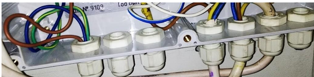
Рисунок 10 – Уплотнительный ввод для кабелей в щите
