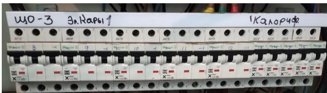
Рисунок 9 – Ошиновка щита соединительной гребенчатой шиной
