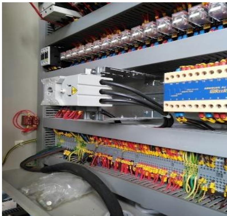
Рисунок 7 – Маркировка проводников в электрическом щите
