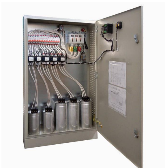
Рисунок 5 – Шкаф батареи конденсаторов
