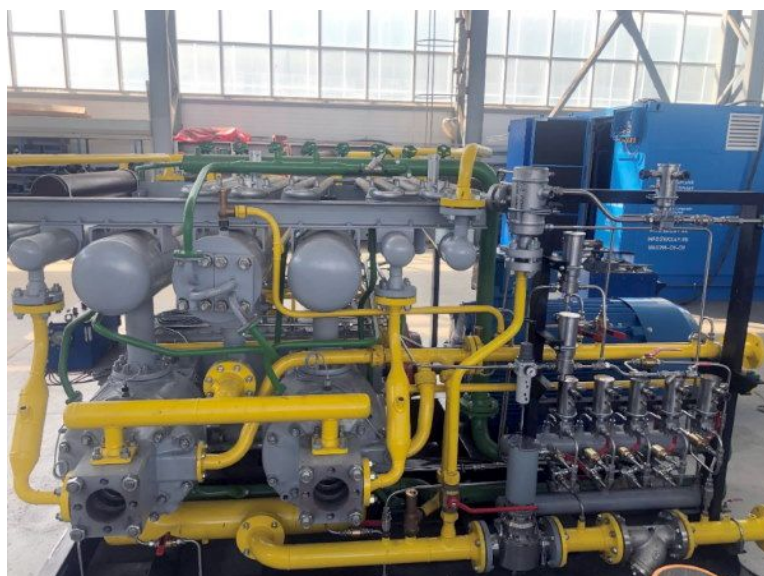
Рисунок 3 – Компрессор АГНКС от Краснодарского Компрессорного Завода
