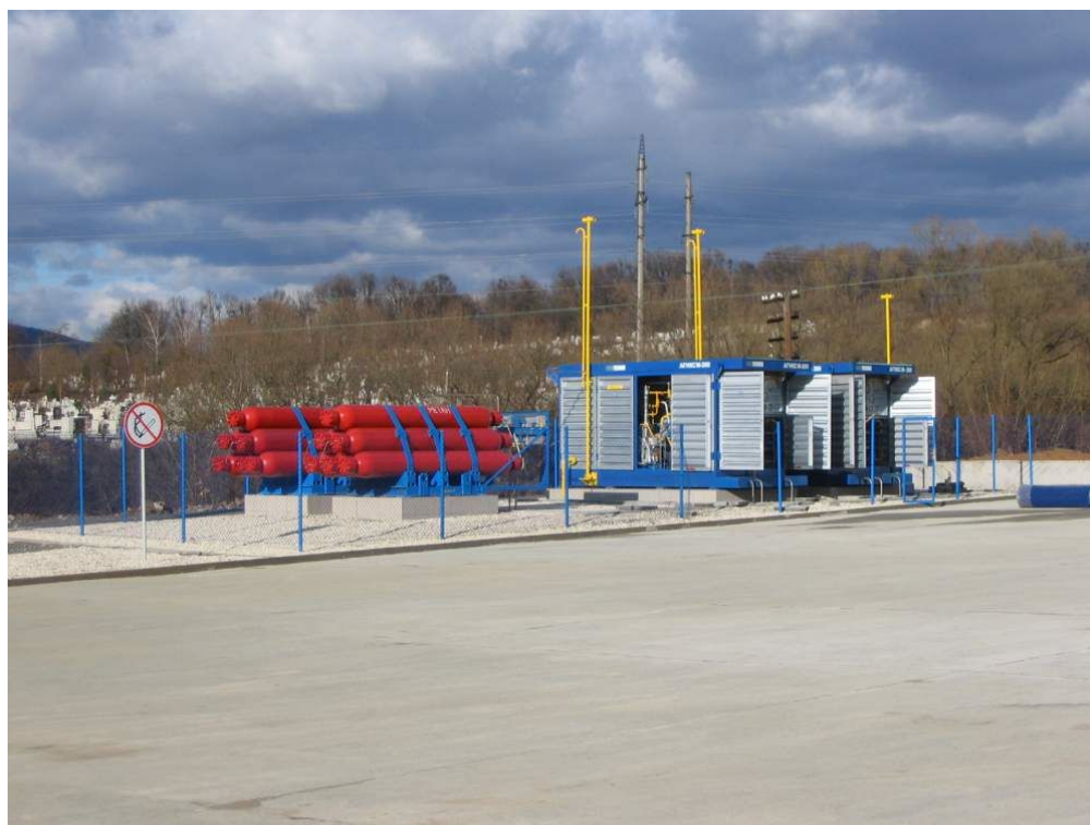
Рисунок 1 – Автомобильная газонаполнительная компрессорная станция блочного исполнения АГНКС БИ «МЕТАН»
