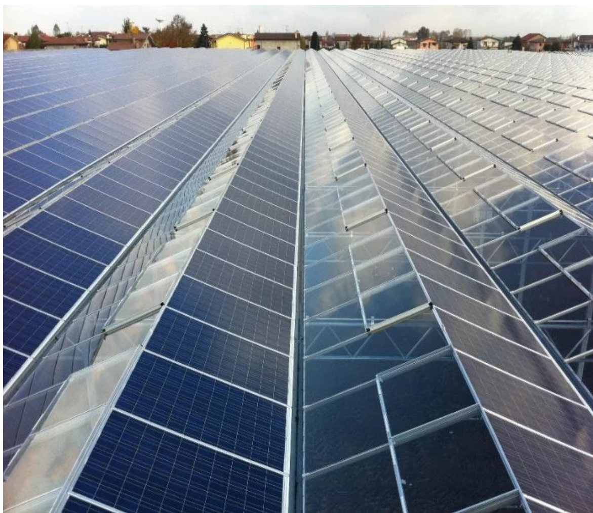
Рисунок 17 – Фотоэлектрические панели на кровле здания
