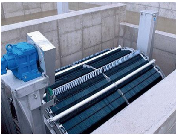
Рисунок 7 – Оборудование для очистки сточных вод
