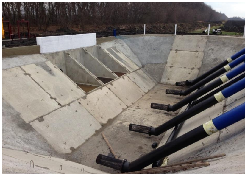
Рисунок 48 – Установленные в ковше фильтрующие элементы открытого типа
