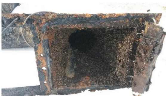
Рисунок 54 – Демонтированный водоприемник из углеродистой стали Новолядовского водозабора на р. Сылва Пермский край [32]
