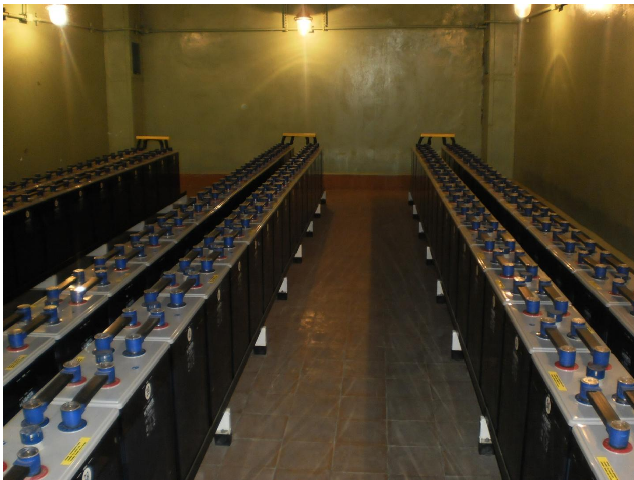
Рисунок 3 – Аккумуляторные батареи питания АО
