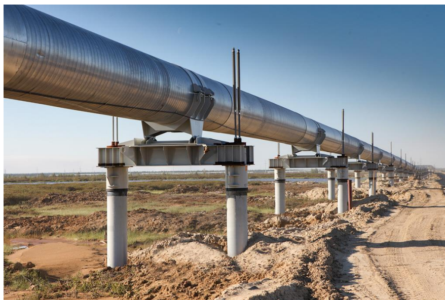
Рисунок 7 – Надземная прокладка трубопровода
