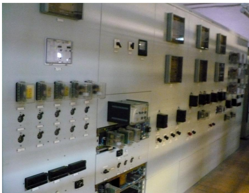
Рисунок 1.2 – Главный щит управления ГПП-6 на основе микропроцессорной релейной защиты
