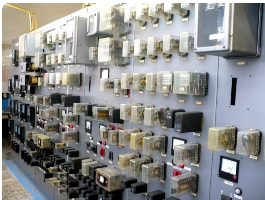
Рисунок 1.1 – Главный щит управления ГПП-1 на основе электромеханических реле
