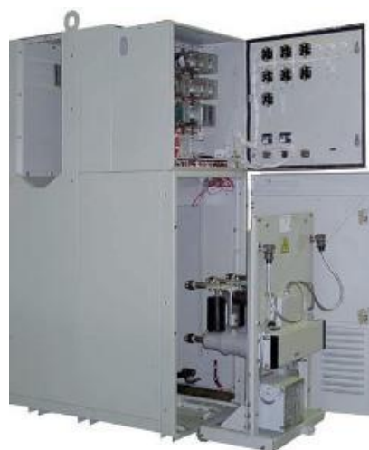
Рисунок 21 – Шкаф КРУ двустороннего обслуживания
