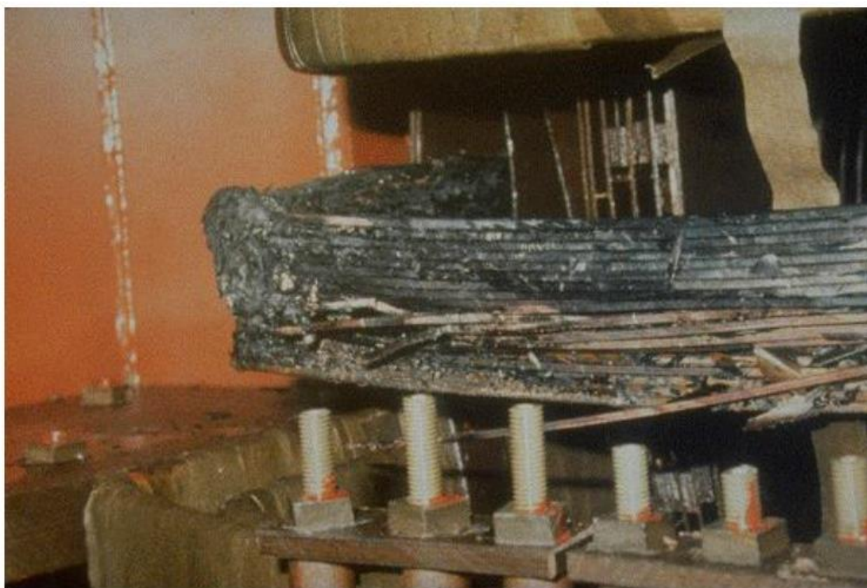
Рисунок 1.1 – Расплавление изоляции и обмоток силового трансформатора на АЭС в Нью-Джерси из-за перегрева во время ГМБ (13-14 марта 1989 г.)
