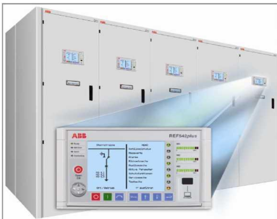
Рисунок 2.5 – Реле REF 542 plus установленное в КРУ
