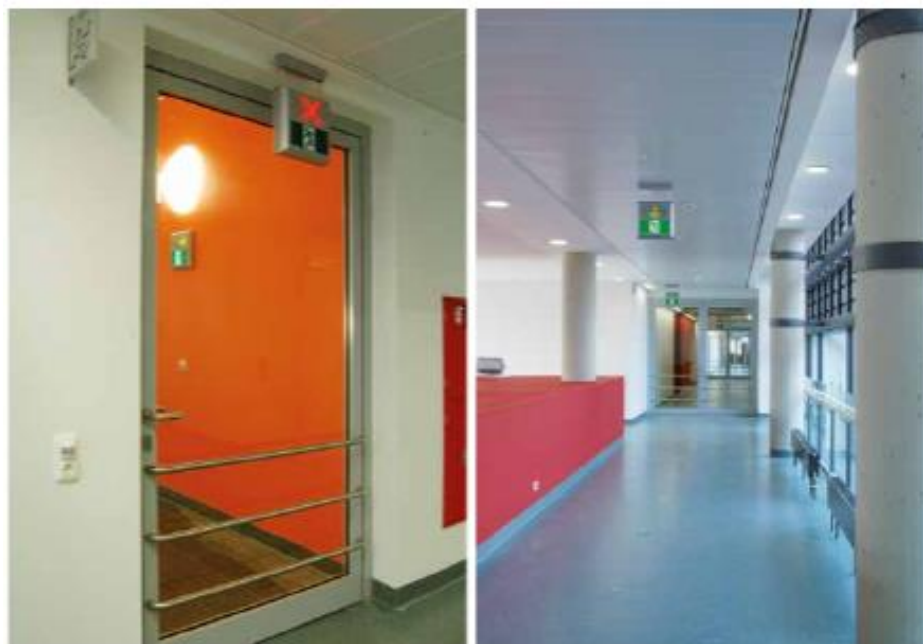
Рисунок 22 – Пример блокирования выхода на лестничную клетку
