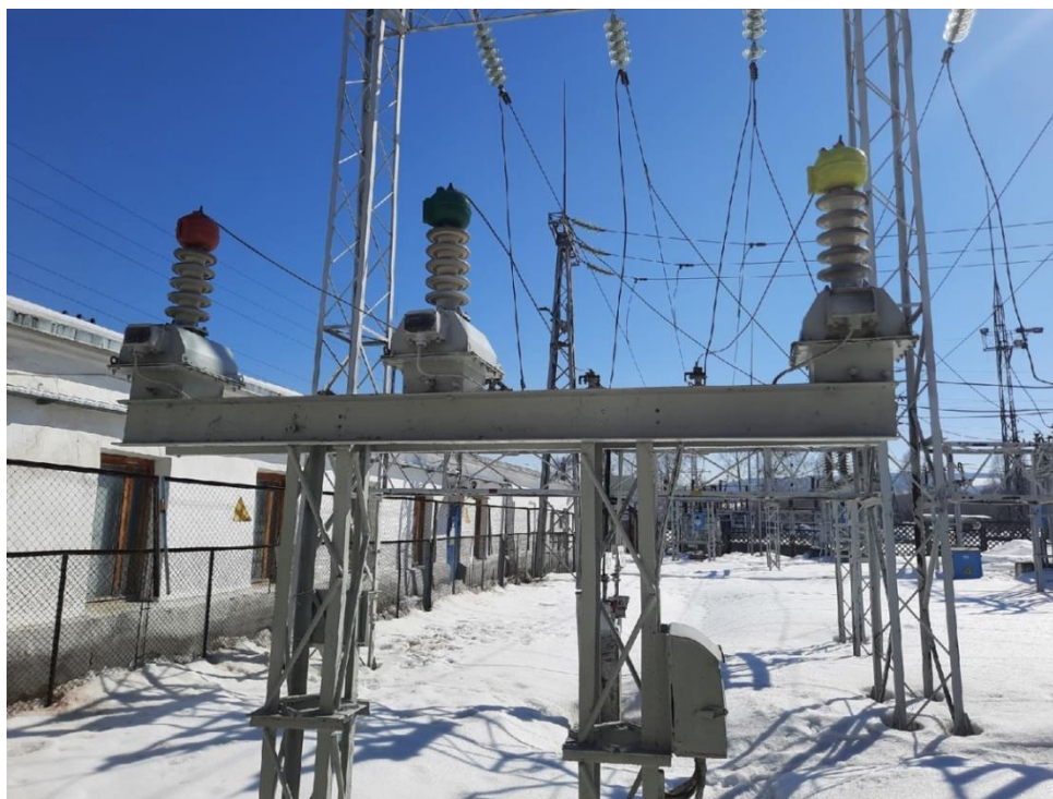
Рисунок 9 – Фотография трансформатора напряжения ЗНОМ-35-65
