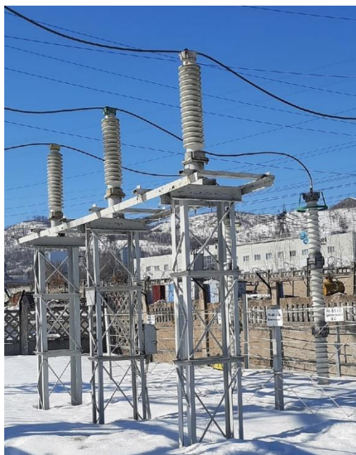
Рисунок 26 – Фото РВС-110 и блока опорных изоляторов
