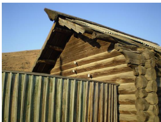
Рисунок 2 - Охлупень на кровле старого дома. Село Десятниково, Тарбагатайский район Бурятии, 15 апреля 2009 год
