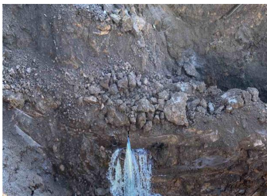
Рисунок 8 - Место разгерметизации трубопровода
