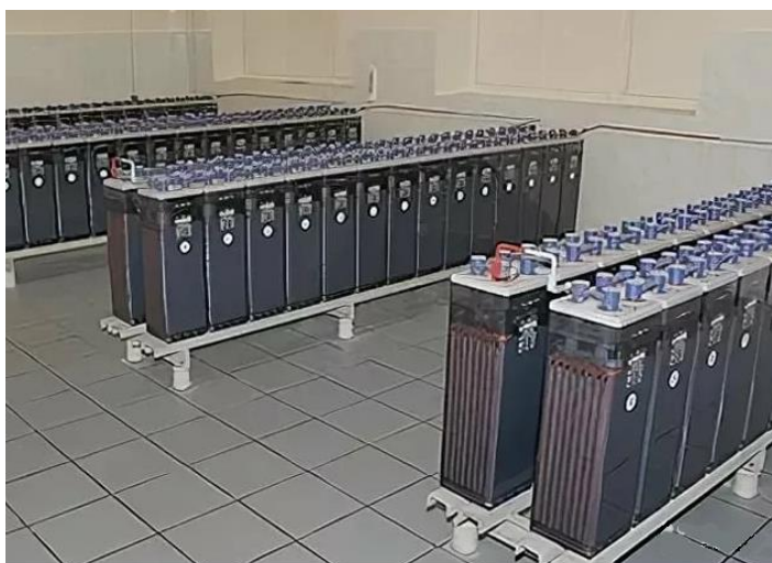
Рисунок 6 – Аккумуляторные батареи питания АО
