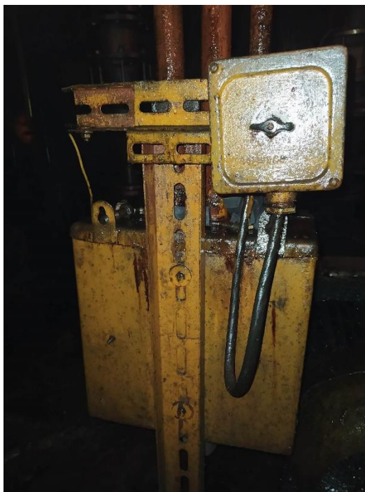
Рисунок 8 – Пакетный выключатель двигателя насосного агрегата подачи СОЖ
