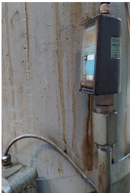
Рисунок 24 – Аналоговый датчик абсолютного давления, установленный на напорном трубопроводе.
