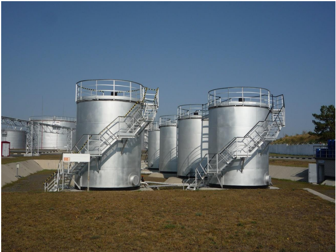
Рисунок 4 – Фото резервуарного парка масел
