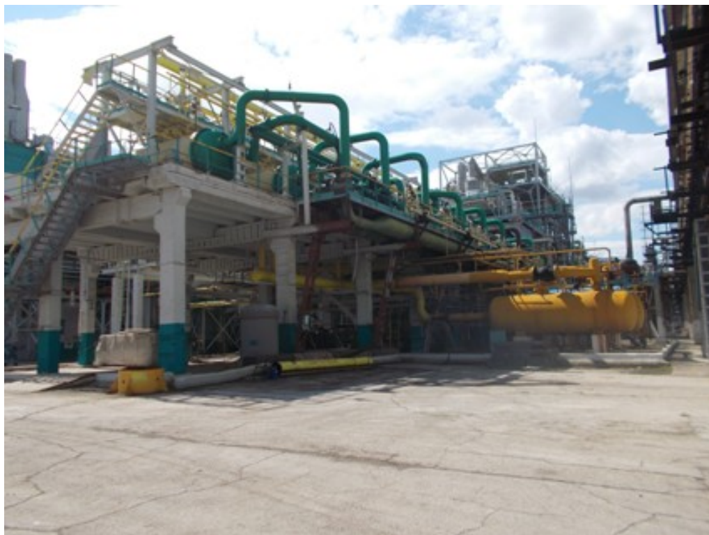
Рисунок 2 – Общий вид наружной технологической установки производства бутилкаучука в ООО «Тольяттикаучук»
