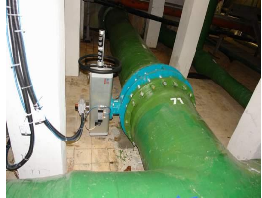
Рисунок 61 – Трубопровод du=600 мм с арматурой и пневмоприводом
