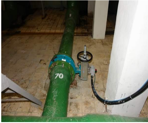
Рисунок 60 – Трубопровод du=250 мм с арматурой и пневмоприводом
