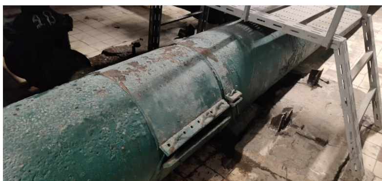
Рисунок 5 – Стальные трубопроводы, поврежденные коррозией
