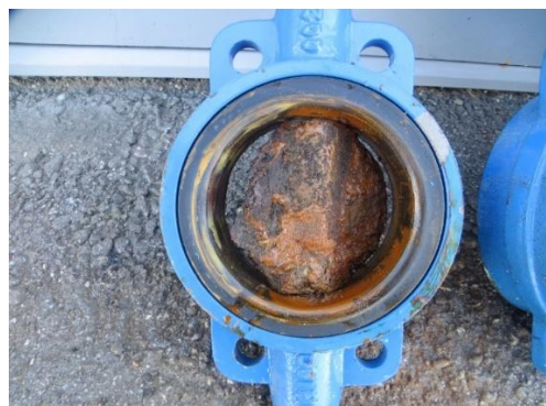
Рисунок 55 – Дисковый поворотный затвор с поврежденным коррозией ДИСКОМ
