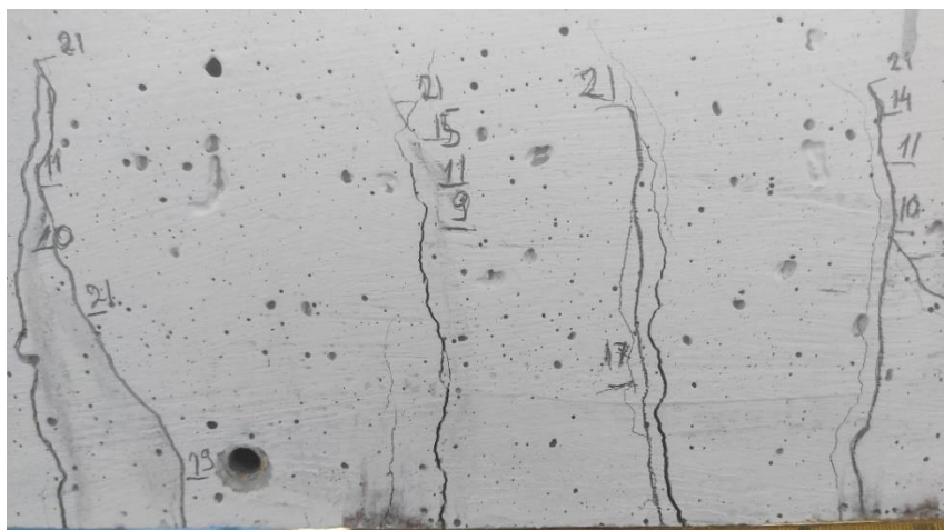
Рисунок 15 – Трещины и ширина их раскрытия
