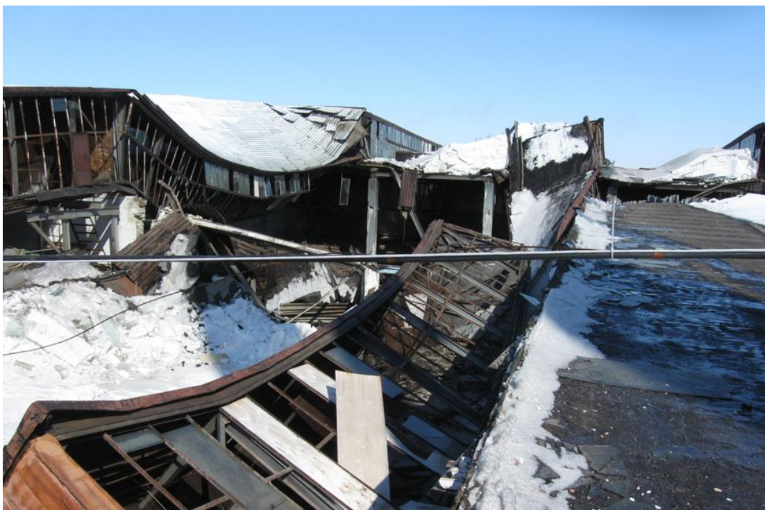
Рисунок 4 – Обрушение крыши производственного цеха
