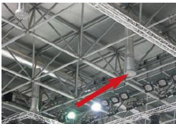
Рисунок 2.4 – Воздухораспределительные устройства, расположенные под потолком арены
