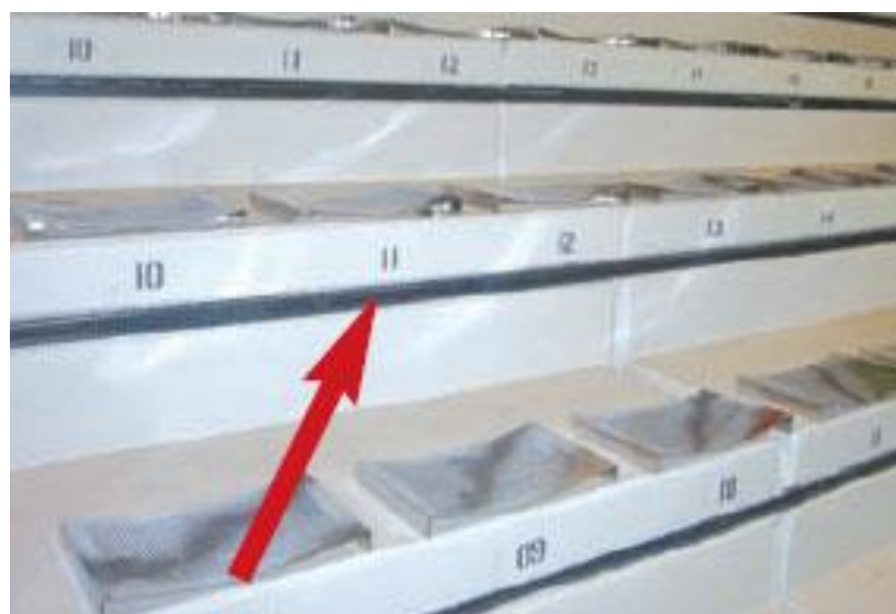
Рисунок 2.3 – Воздухораспределительные устройства, установленные под
