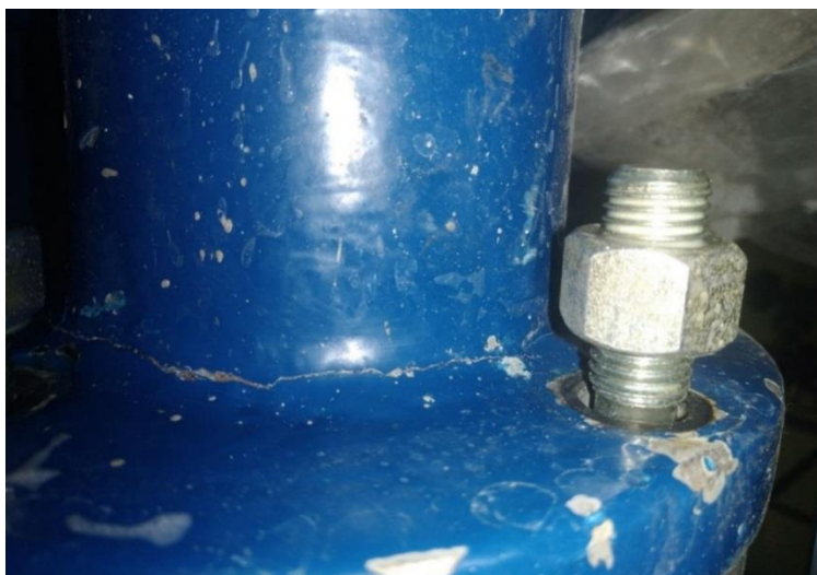
Рисунок 2 – Трещина в корпусе маслонасоса
